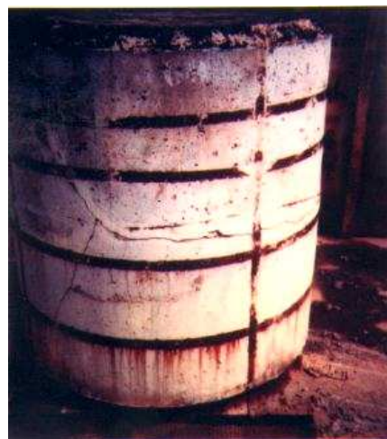
Coque bétonnée fissurée
