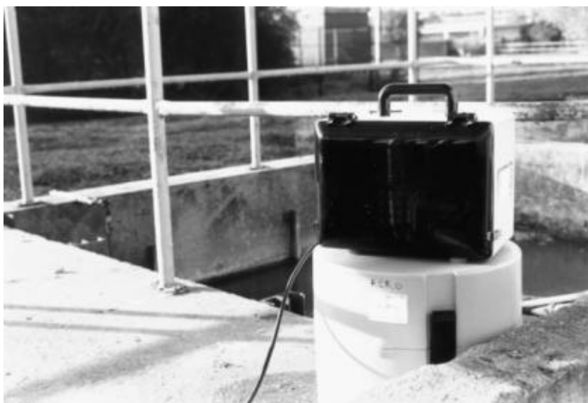
Photo 1 : Préleveur automatique en position à l'entrée de la station (avant prétraitement).
